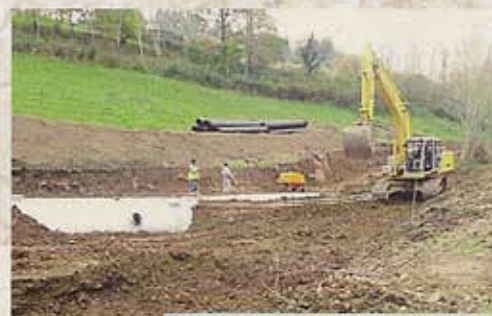
→ les citernes enterrées
